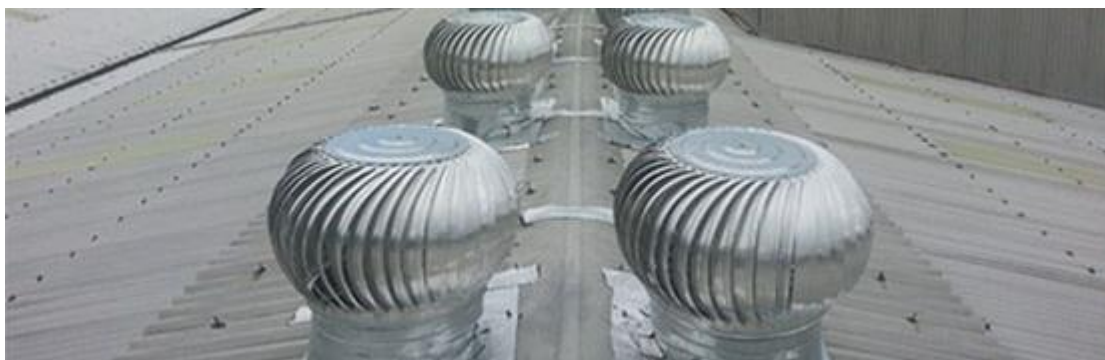
Ilustración 11: Ventilación con extractores eólicos.
